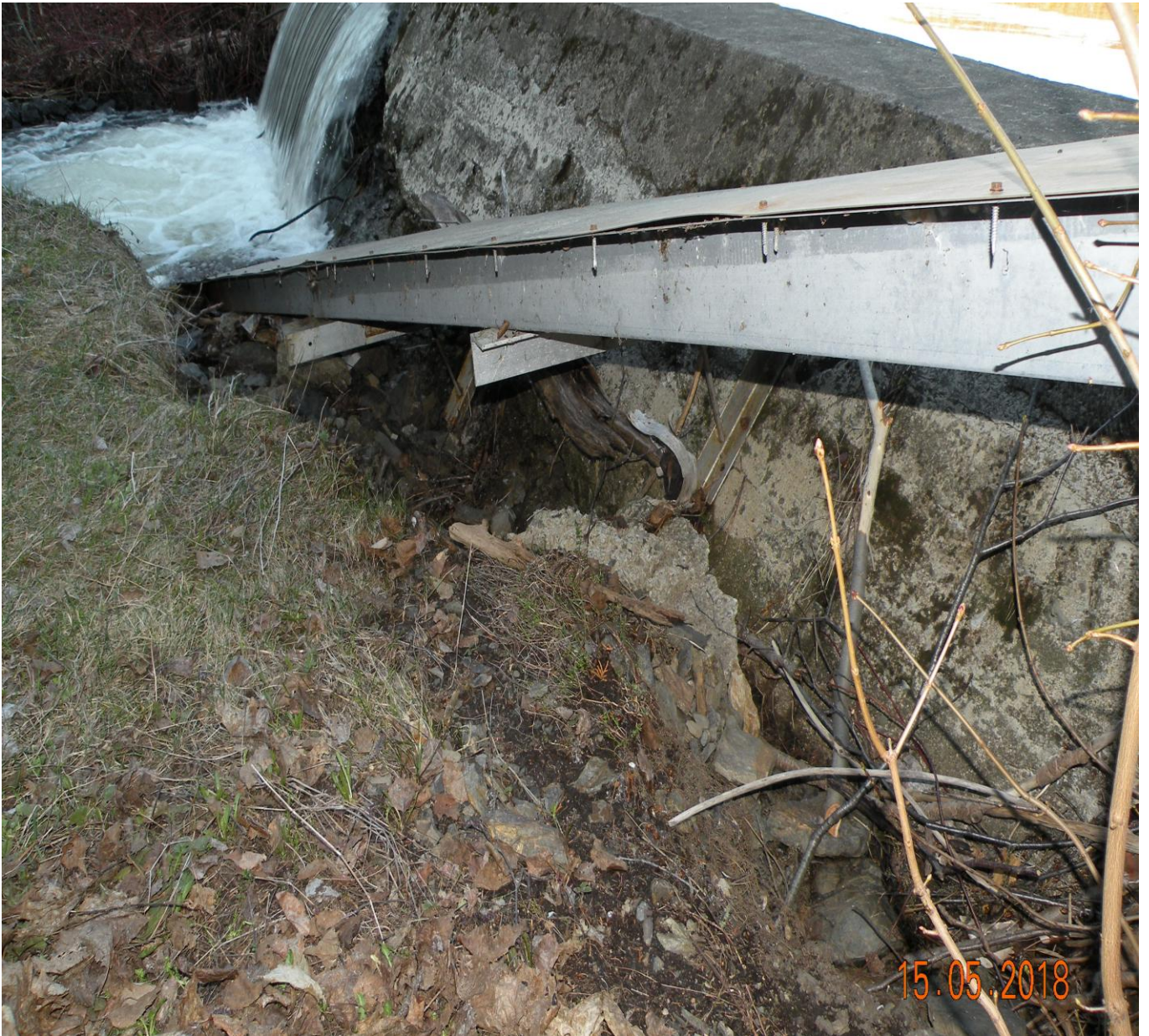
Affouillement * au pieds du barrage, causé par les crues printanières.
